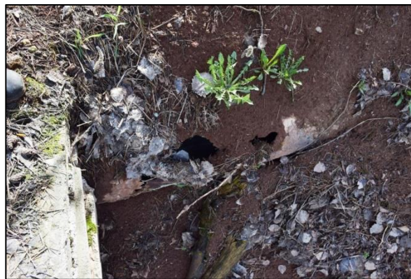
Рис. 12.21. Разрушение трубы около канализационного колодца на бровке правого борта оврага (г. Киров)
