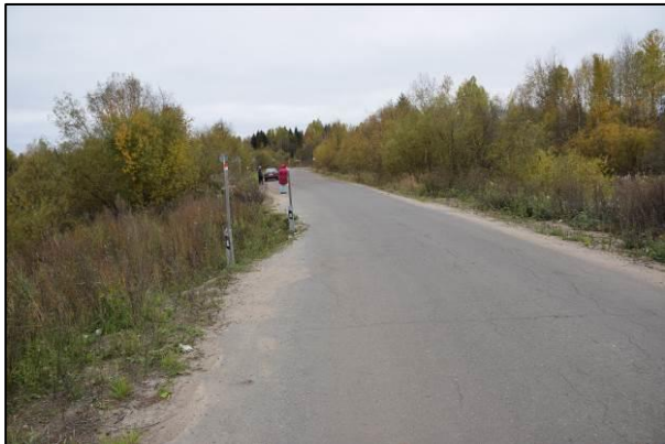
Рис. 12.15. Аварийный участок автодороги Кирс–Южаки (с. Лойно) в 2025 г.
