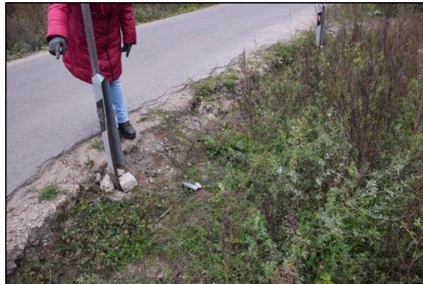
Рис. 12.16. Сползание гравийной отсыпки автодороги в районе с. Лойно Верхнекамского района
