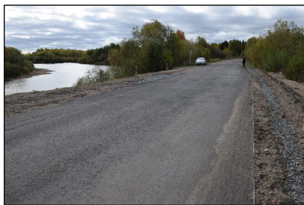
Рис. 12.16. Выполненное расширение и асфальтирование проезжей части автодороги Кирс–Южаки (с. Лойно) в 2023 году
