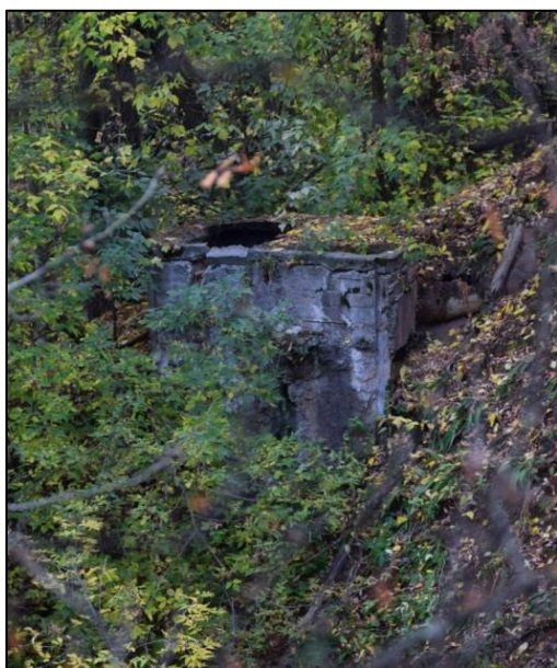
Рис. 12.20. Канализационный колодец на бровке правого борта оврага за санаторием-профилакторием Авитек г. Кирова
