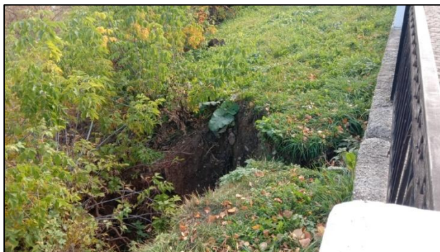
Рис. 12.23. Вершина промоины у пешеходной дорожки Александровского парка г. Кирова
