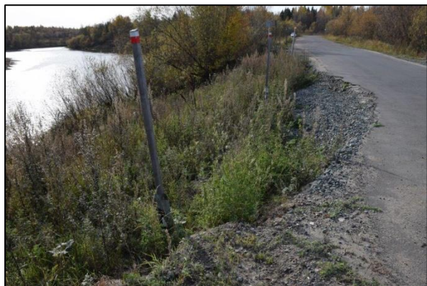
Рис. 12.15. Частичное разрушение асфальтового покрытия автомобильной дороги в районе с. Лойно Верхнекамского района
