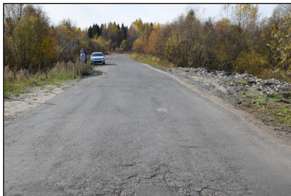
Рис. 12.16. Аварийный участок автодороги Кирс–Южаки (с. Лойно) в 2024 году
