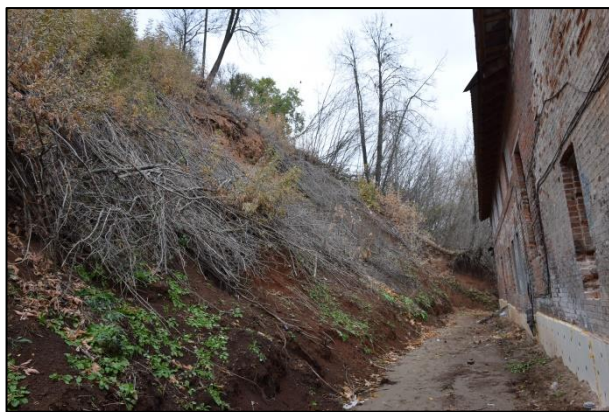
Рис. 12.21. Оголенный участок склона р. Вятка за зданием ул. Пристанская, д. 5 г. Кирова
