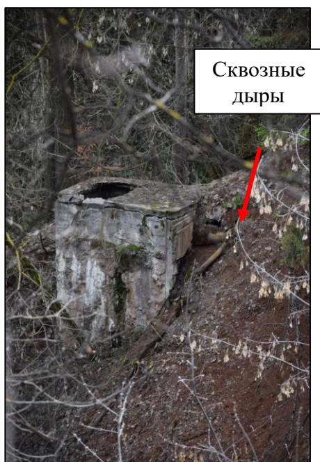
Рис. 12.19. Канализационный колодец на бровке правого борта оврага за санаторием-профилакторием Авитек г. Кирова
